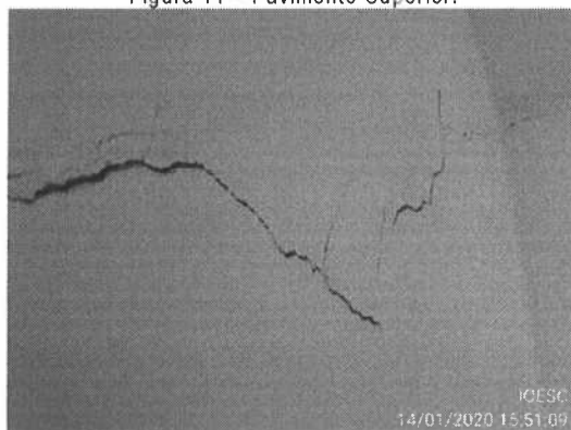
Figura 16 – Pavimento Superior – Sala com trinca em alvenaria.
