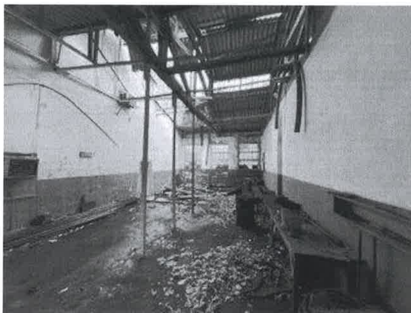
Vista interna do imóvel avaliando, com partes em ruínas
