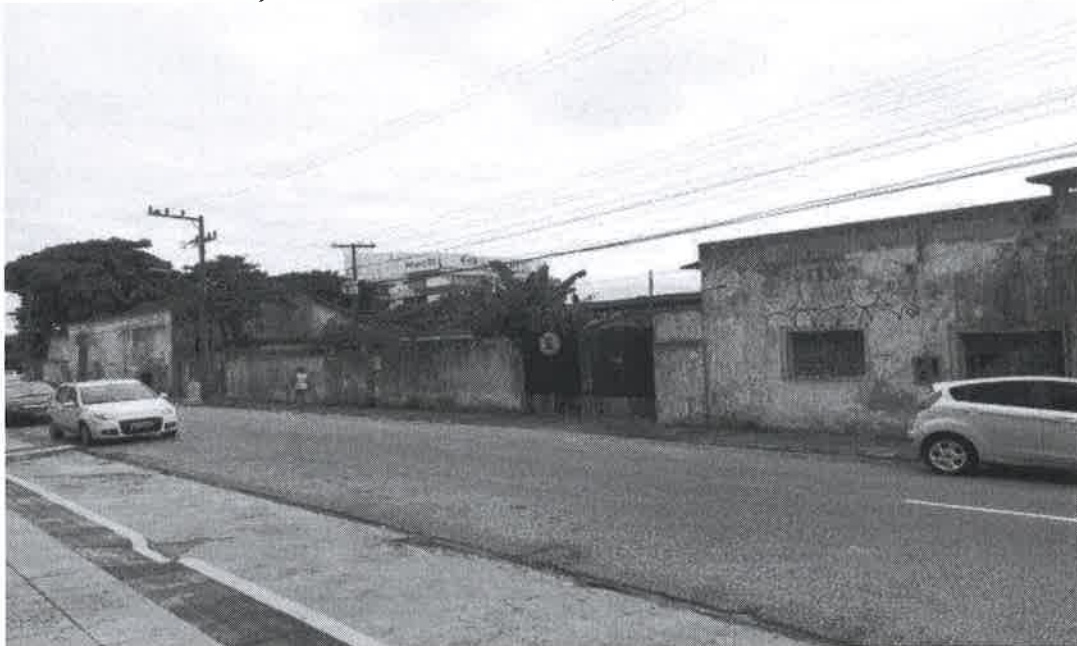
Elevação frontal do imóvel avaliando a partir da Rua Doutor Heitor Blum
