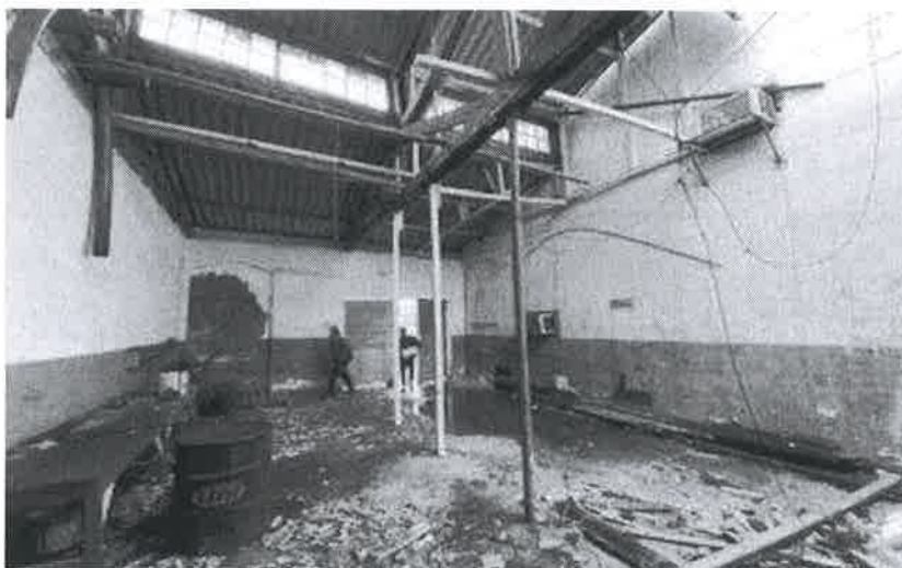
Vista interna do imóvel avaliando, com partes em ruínas
